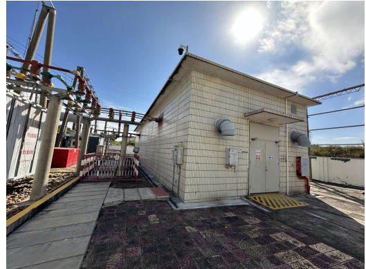
10kV 配电装置室
