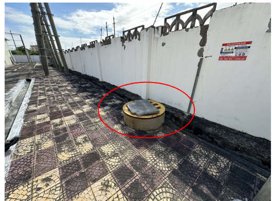
现有事故油池
