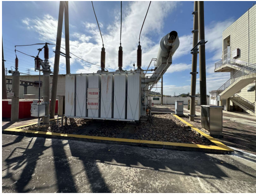
现有 1 号主变 (31.5MVA)
