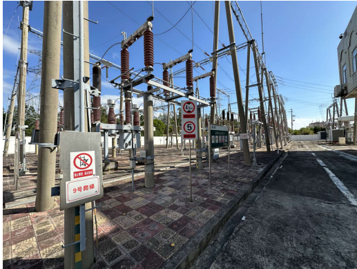
110kV 配电装置区
